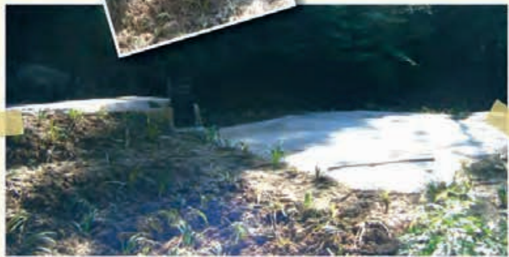
过滤池和蓄水池全貌
